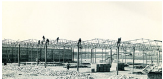
↓ Dograditev nove garaže in poslovnih prostorov tehničnega sektorja na Ljubljanski cesti v Kopru (1959).
